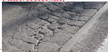
FESSURAZIONI RAMIFICATE (PELLE DI COCCODRILLO)
