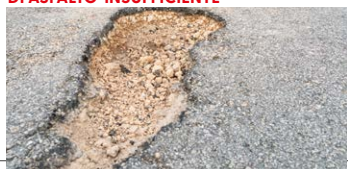
STRADE CON SPESSORE DI ASFALTO INSUFFICIENTE
