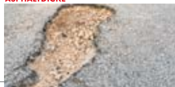
STRASSEN MIT ZU GERINGER ASPHALTDICKE
